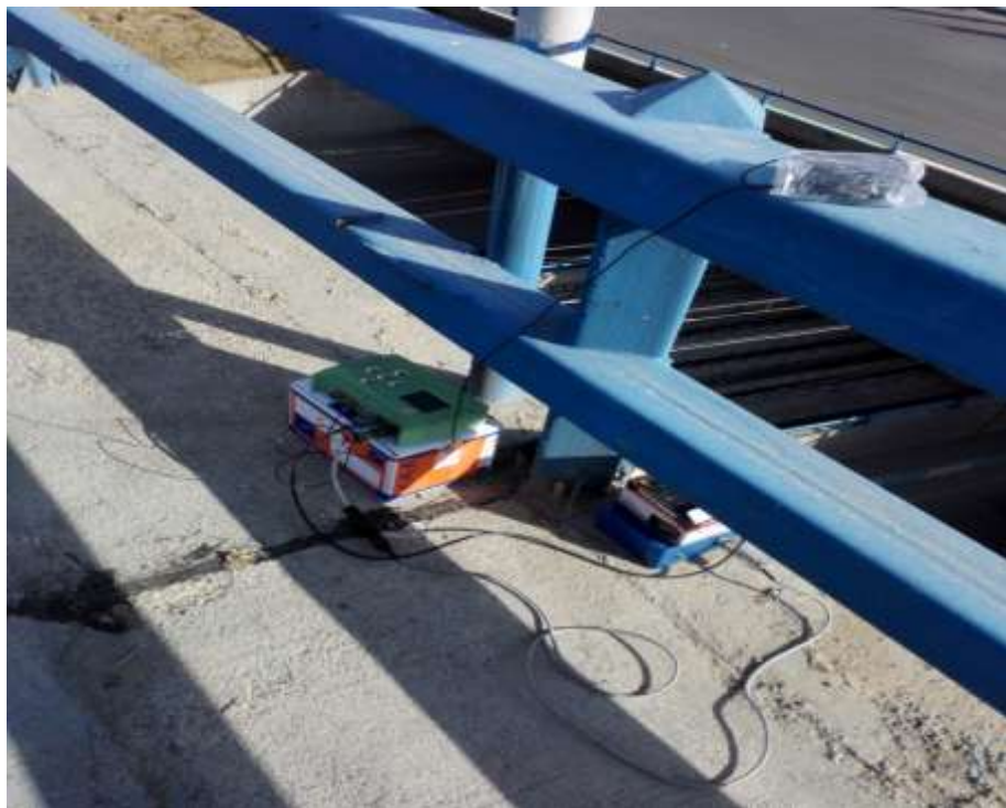
شکل شماره ۱۵: استقرار حسگر شتاب - پل چمران
