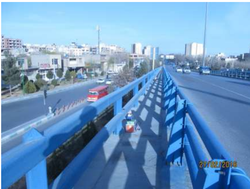
شکل شماره ۷: استقرار حسگر شتاب ۳ (آزمایش ۱) - پل چمران
