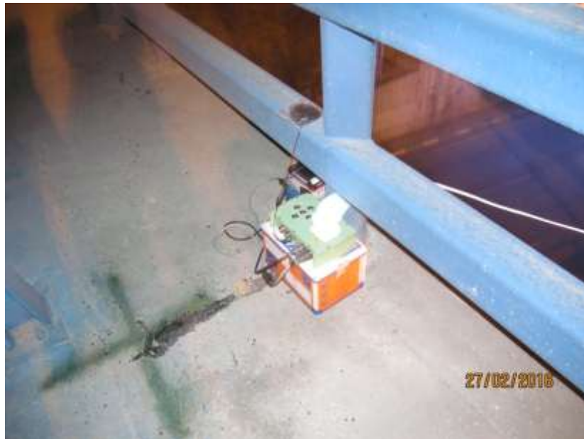
شکل شماره ۱۱: استقرار حسگر شتاب - پل چمران
