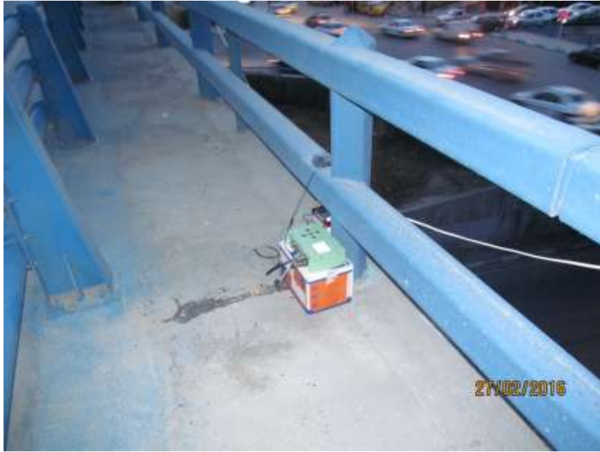
شکل شماره ۸: استقرار حسگر شتاب - پل چمران
