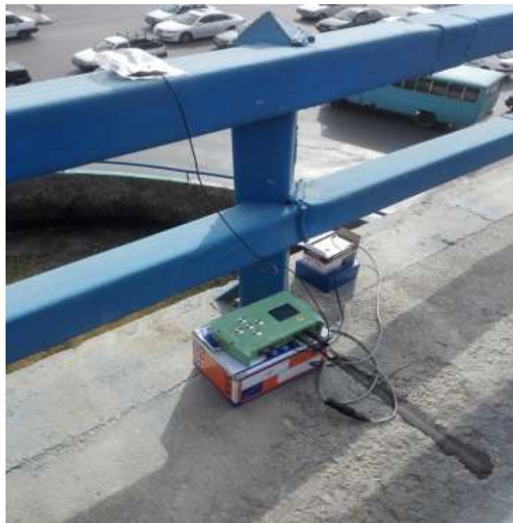
شکل شماره ۱۷: استقرار حسگر شتاب ۵ (آزمایش ۹) - پل چمران
